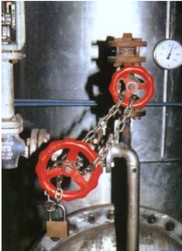
Durch Schloss gesicherte Absperrvorrichtung
