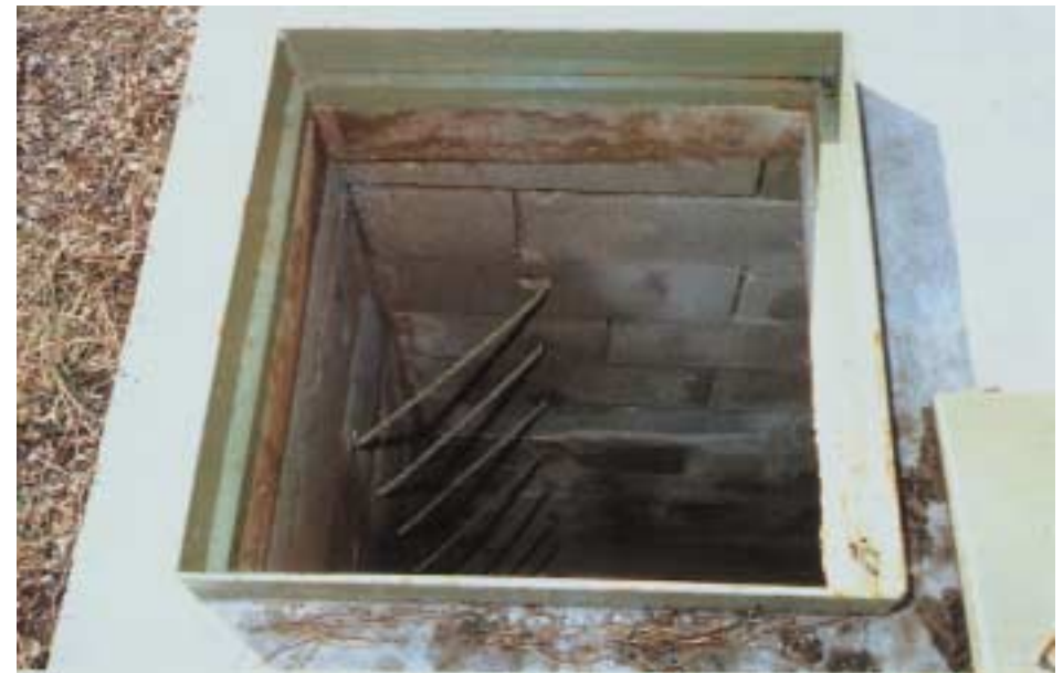
Der Schacht – ein typischer Behälter
