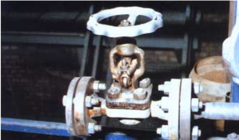
Die sicherste Art des Abtrennens ist das Blindflanschen
