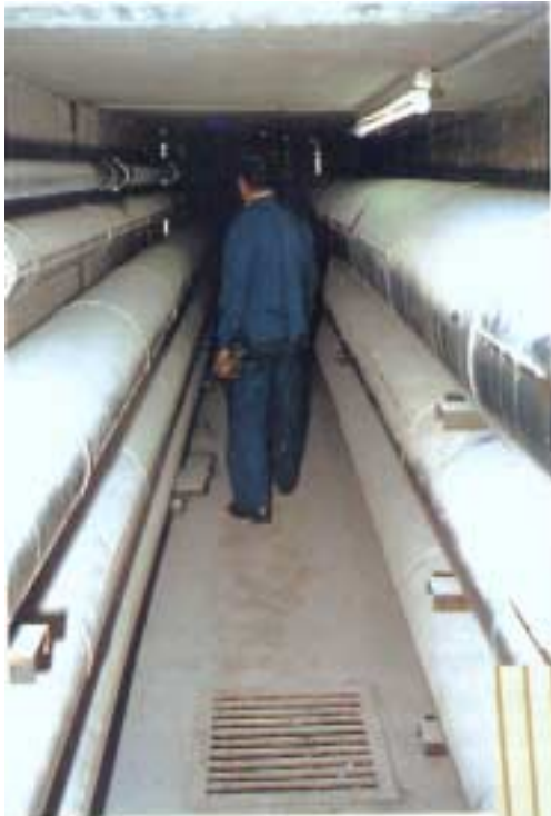
Regelmäßig befahrener Behälter, in dem Rohrleitungen verlegt sind; Sicherheitsmaßnahmen siehe Seite 23
