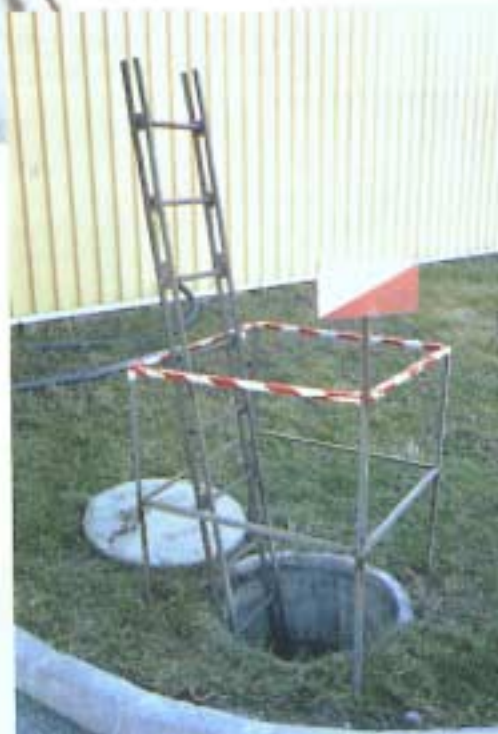
Hoffentlich ist bei diesem Schacht keine ständig anwesende Person für Rettungsmaßnahmen notwendig!
